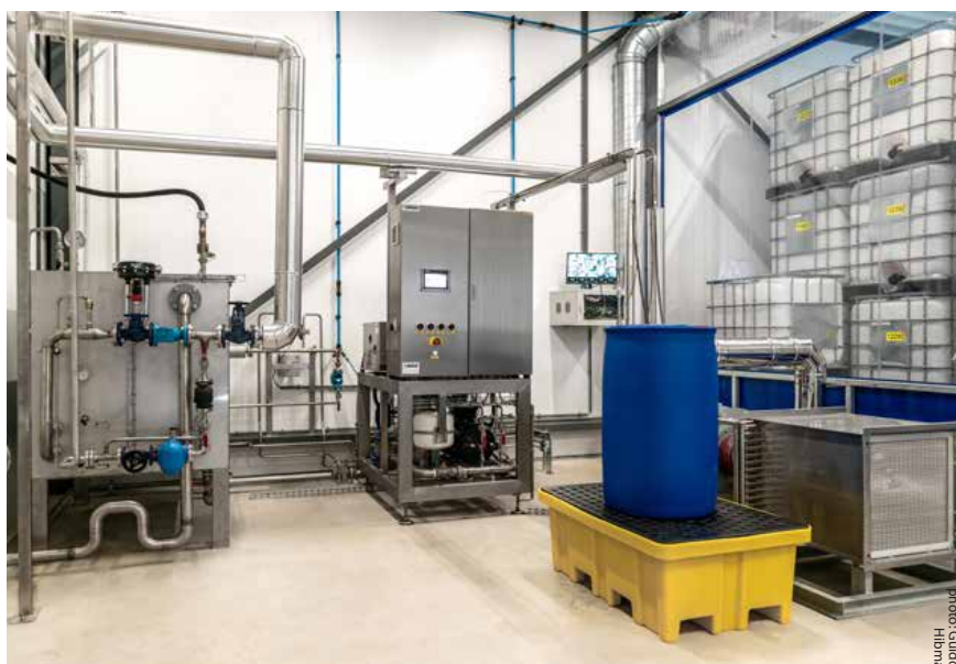
De technische ruimte
