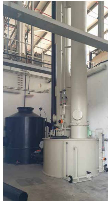
Gaswasser met koolfilter op de achtergrond (RSA Talke Dubai)
